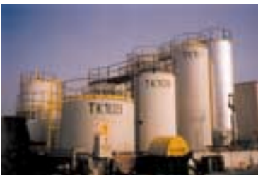
Parco serbatoi stoccaggio olio combustibile recuperato
